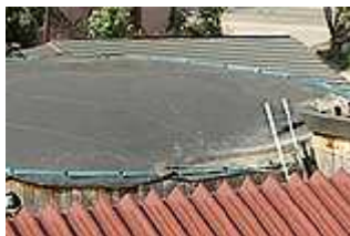
Die erste Biogasanlage von Bauer Gebhardt ...
